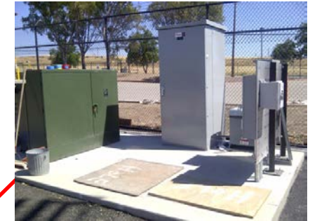
500 kVA, 480 V transformer
