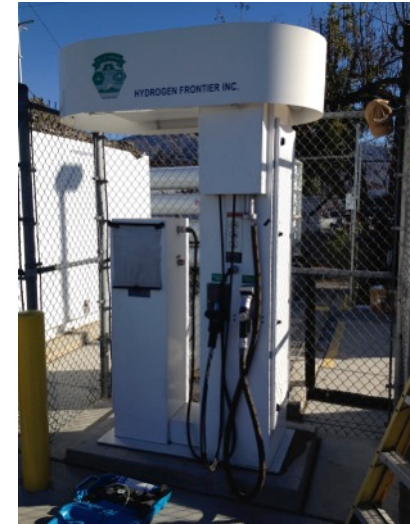
Conduit for 24V DC power
