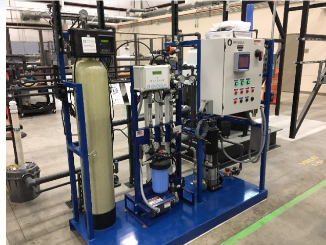
DI Water System
